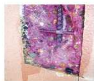
中性化深さ測定
