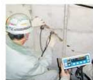
超音波法による欠陥部測定
