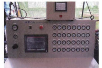
■ 自動管理操作盤及びモニター
